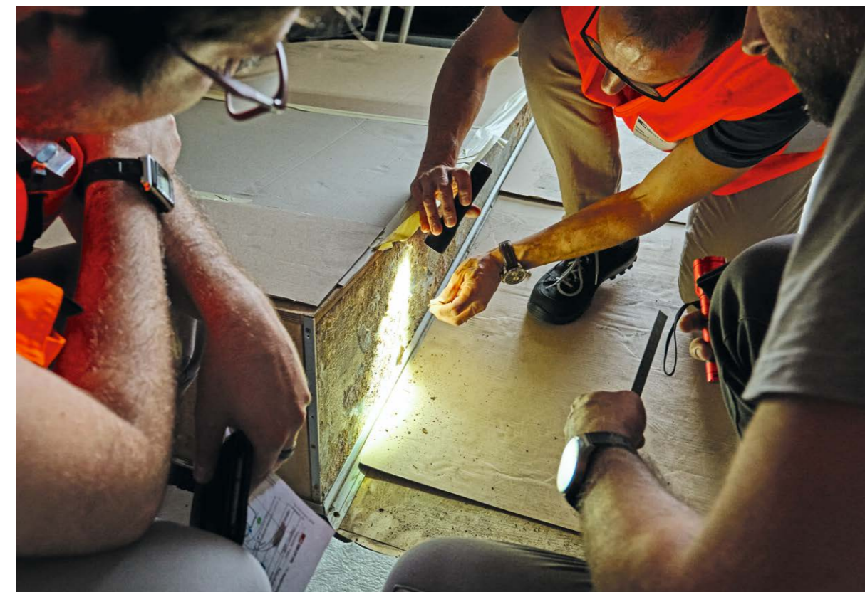
Wo ist das Wasser eingedrungen? Die Spezialisten der SOB und der SBB gehen auf Spurensuche.
